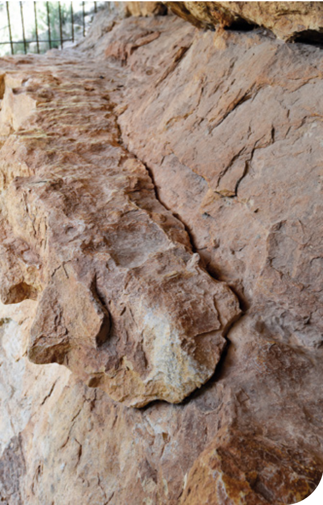
Abrigo de la Balsa de Calicanto, en el Barranco Moreno (Bicorp, Valencia). En este abrigo se aprecia la separación de la pared de un gran bloque calizo que amenaza con desprenderse, con el consiguiente riesgo para los visitantes. Foto MSN.
